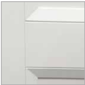
faza na łączeniu ramiaków
